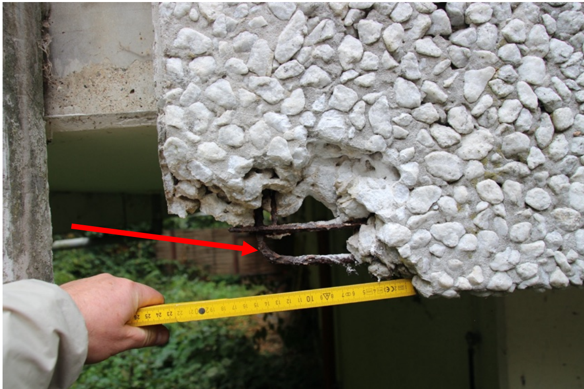
Abb. 8: Nebengebäude, 1. Geschossebene, Betonschaden in der überhängenden Schürze der Brüstung mit erheblich korrodiertem Stahlbewehrung
